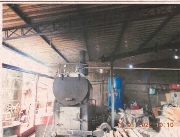
Foto 03: Caldeira a vapor.
