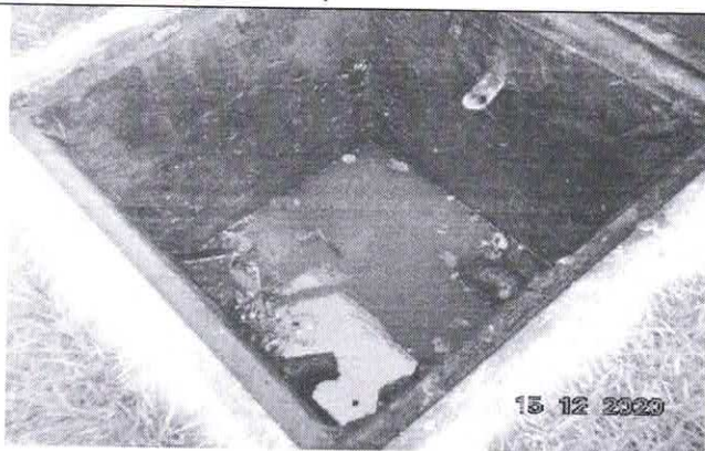
Foto 03: Caixa separadora de água e óleo.
