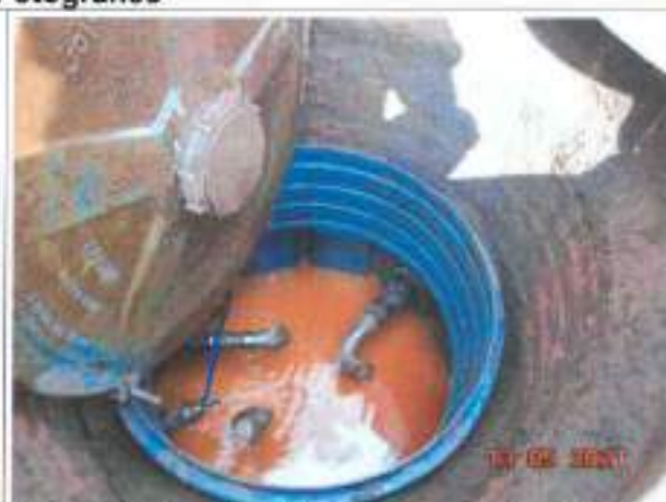
Figura 2: Boca de visita com acumulo de água.
