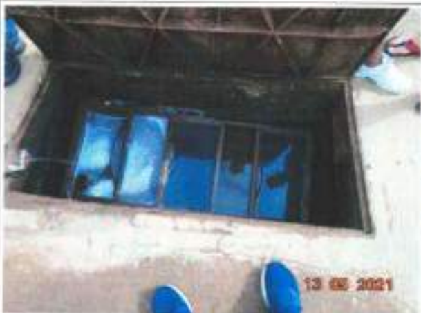
Figura 5: Caixa SAO em bom estado.
