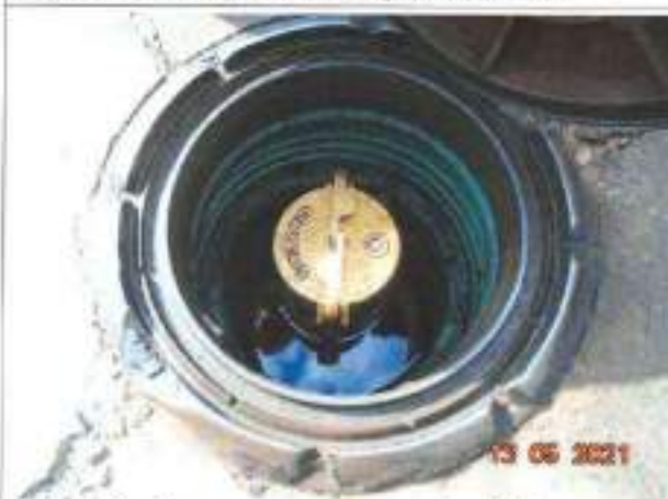
Figura 3: Descarga com acumulo de água.
