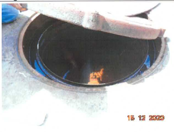
Figura 2: Boca de visita com acumulo de água.
