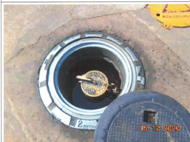
Figura 3: Descarga com acumulo de água.
