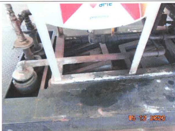
Figura 4: Filtro prensa apresentando vazamento.
