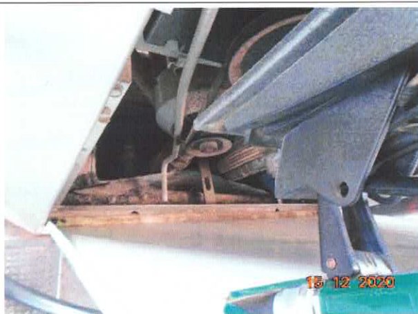
Figura 6: Sump da bomba mal instalado.
