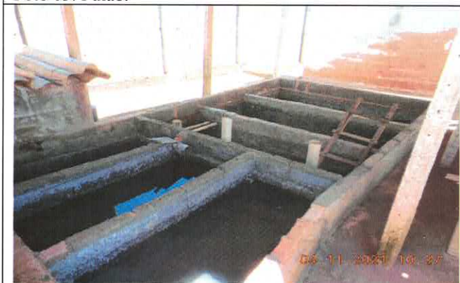
Foto 05: Estação de Tratamento de Efluentes
