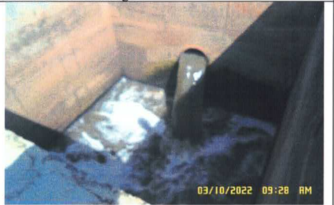
Foto 06: Saída do Efluente Tratado
