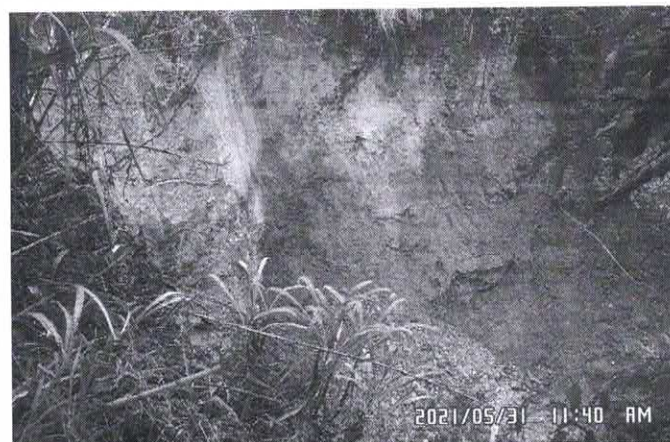
Figura 4: Processo Erosivo a jusante do empreendimento
