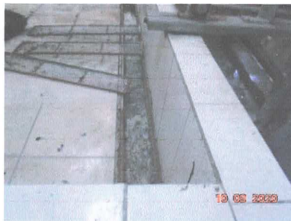
Figura 4: Canaletas de condução do efluente.
