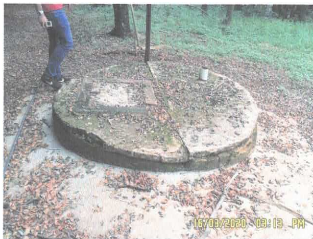
Figura 8: Captação de água subterrânea
