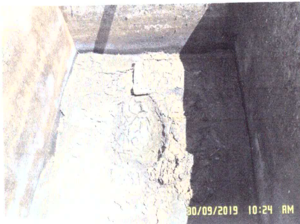
Figura 3: Tanque de secagem do lodo da lagoa
