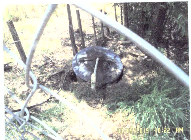
Figura 4: Caixa onde o efluente tratado é bombeado
