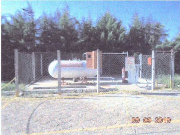
Figura 1: Tanque de GLP
