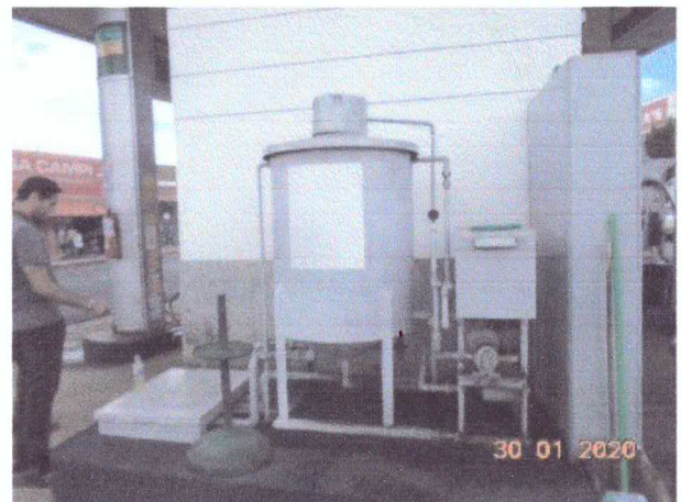
Figura 6: Filtro de diesel sem sump de proteção, com sinais de vazamento.
