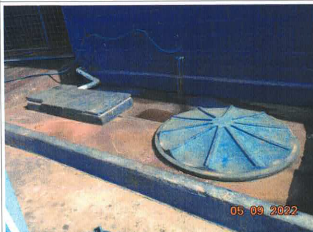
Foto 03: Caixa separadora de água e óleo.
