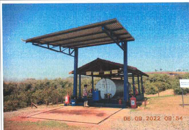
Foto 05: Cobertura danificada na área de bastecimento.
