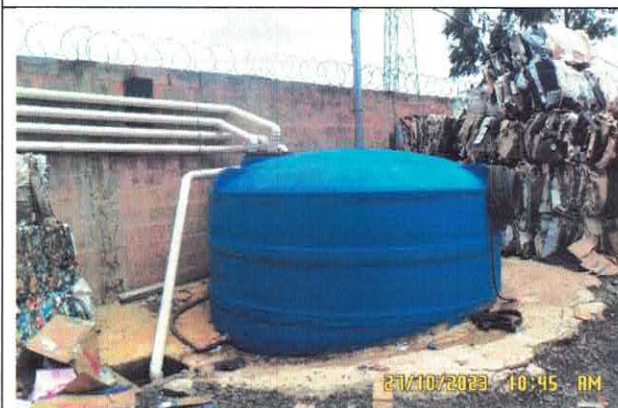
Foto 05: Armazenamento da água da chuva
