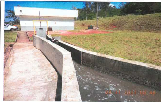
Foto 01: Entrada do efluente após gradeamento
